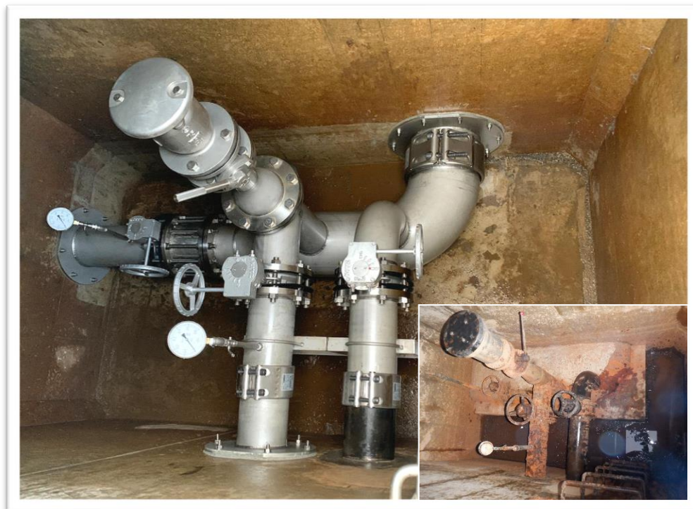
令和3年度 多面的機能支払交付金（長寿命化）弁室制水バルブ等の更新
